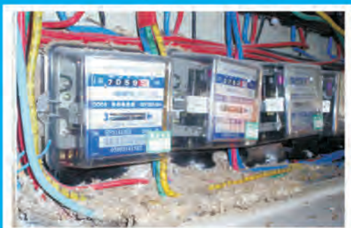
▲ 受白蚁危害的配电箱
